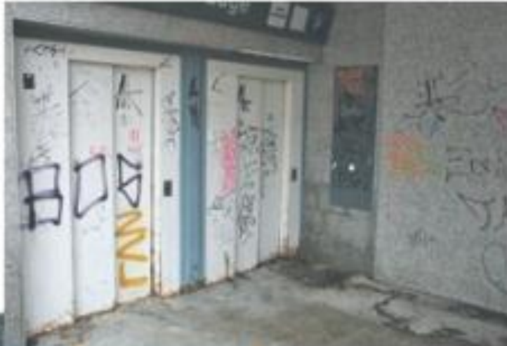
Schandfleck Aufzug: Die Galerie oberhalb der Rieckhoffstraße hat einiges zu bieten.
